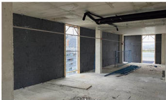
■ Aislamientos termo acústicos en edificio de 180 viviendas PASSIVHAUS en Vitoria . GEOPANNEL® PYL 2.0 60 mm y GEOPANNEL® INPAT.
